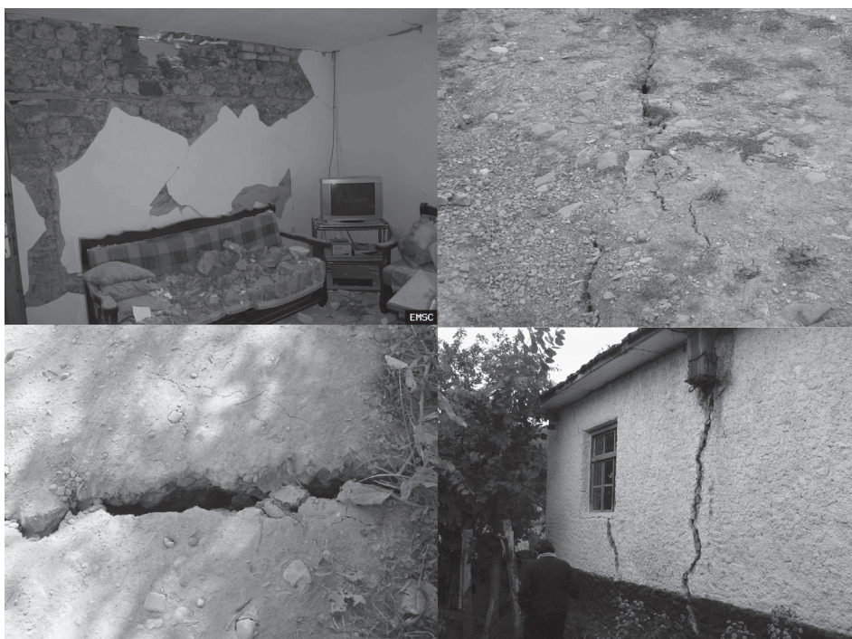
Figura 5. Pamje nga shtepit e rrënuara ne fshatin Qerret dhe çarjet ne toke. Figure 5. View from ruined buildings in Qerret village and ground cracks
